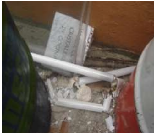
Fuente: Autor – separación inadecuada – área trasera calderas y piscina
