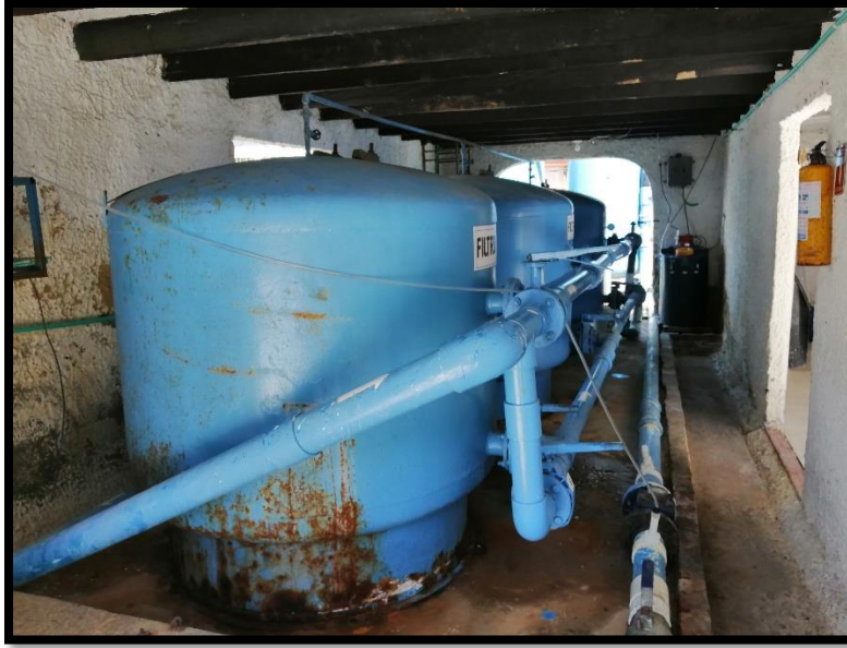
Ilustración 12. Primera etapa de tratamiento ACUALCOS. Fuente[Propia]
