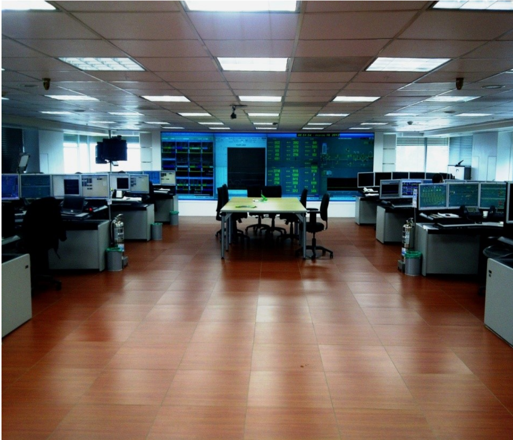
Figura 12 Foto Centro de Control Operacional
