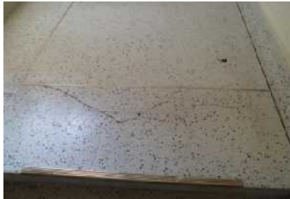
Figura 34. Deterioro descanso piso escalera.
