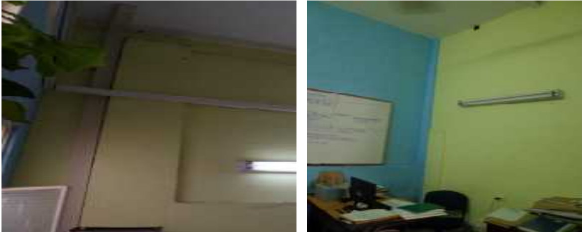
Figura 50. Vista de muros Oficina Planeacion.
