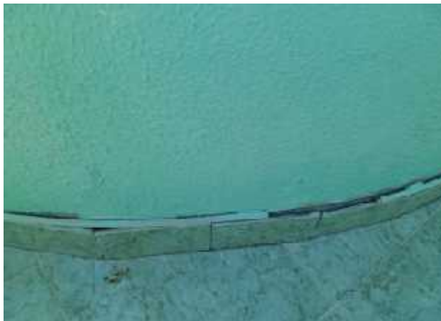
Figura 29. Vista guarda escoba balcón.
