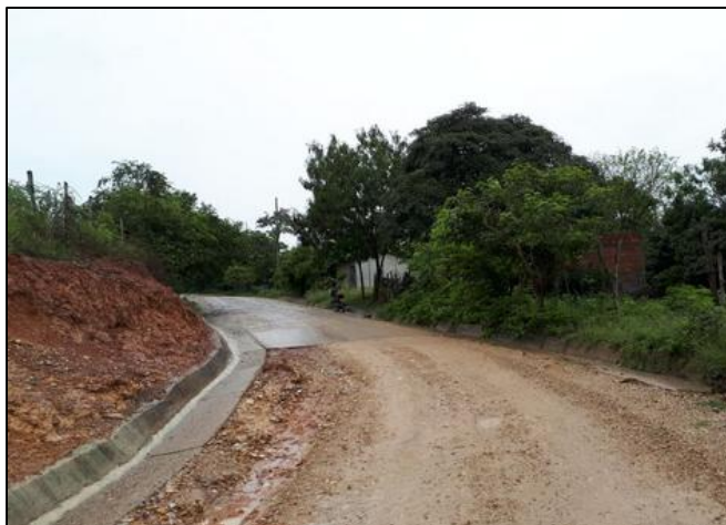
Figura 33. Final de vía,
