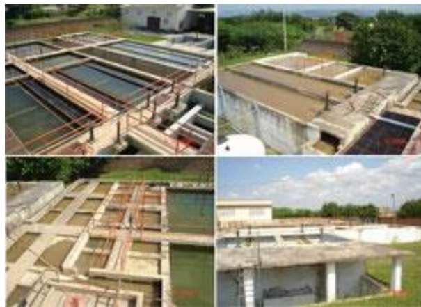
Figura 4. Planta de Tratamiento
