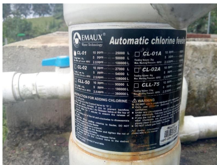
Imagen 14. Bomba Dosificadora de Hipoclorito de Sodio. Fuente: Propia.
