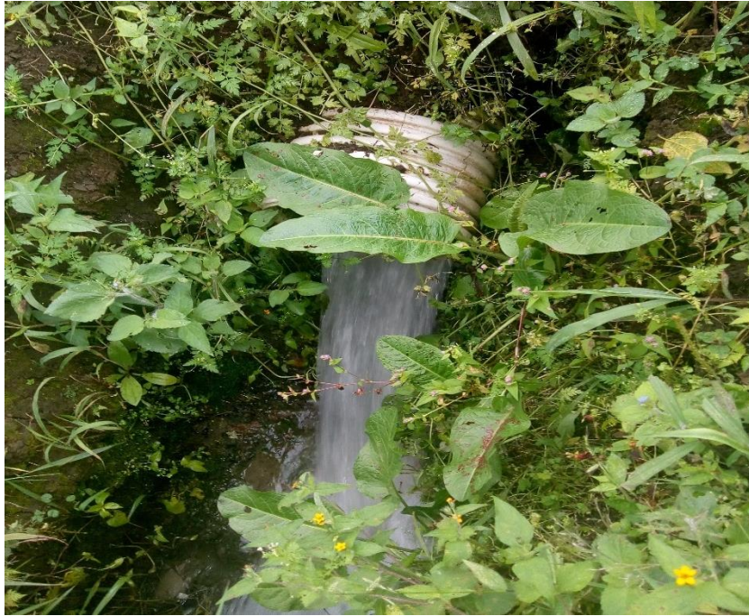
Imagen 17. Vertimiento realizado por la PTAR a la Quebrada la Tribuna. Fuente: Propia.
