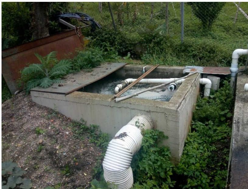
Imagen 10. Tanque de entrada de la PTAR La Victoria. Fuente Propia.
