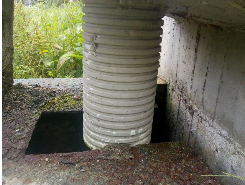
Imagen 15. Salida de la PTAR La Victoria. Fuente: Propia.
