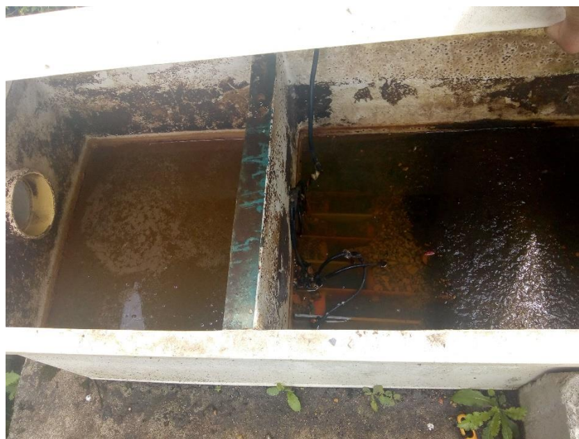
Imagen 11. Tratamiento Primario Avanzado. Fuente: Propia.
