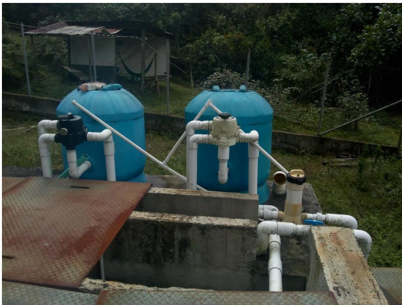
Imagen 13. Sistema de Tratamiento Terciario y Cloración. Fuente: Propia.
