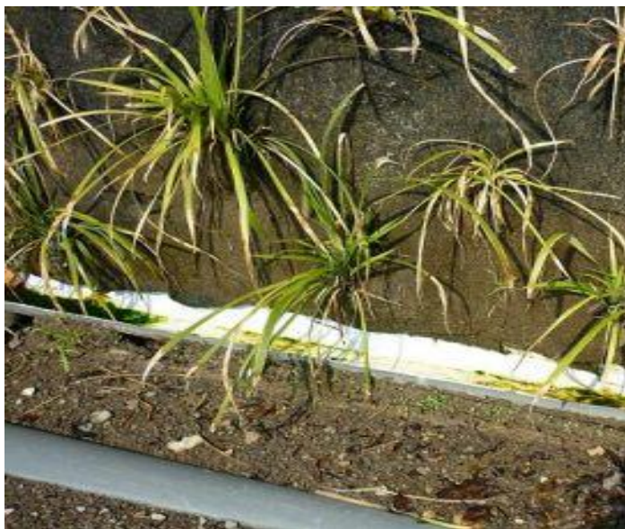
Figura 27. Imagen sistema de riego para fachada verde. Fuente: (Urbanarbolismo, 2008)
