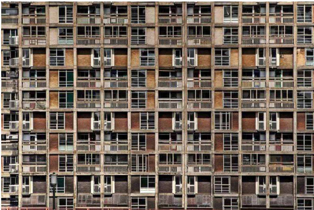
Figura 8. Park Hill en abandono
