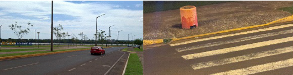
Figura 2. Veredas con deterioros significativos y cambios de nivel abruptos Fuente: elaboración propia. Figure 2. Pathways with significant deterioration and abrupt level changes Source: Own elaboration.
