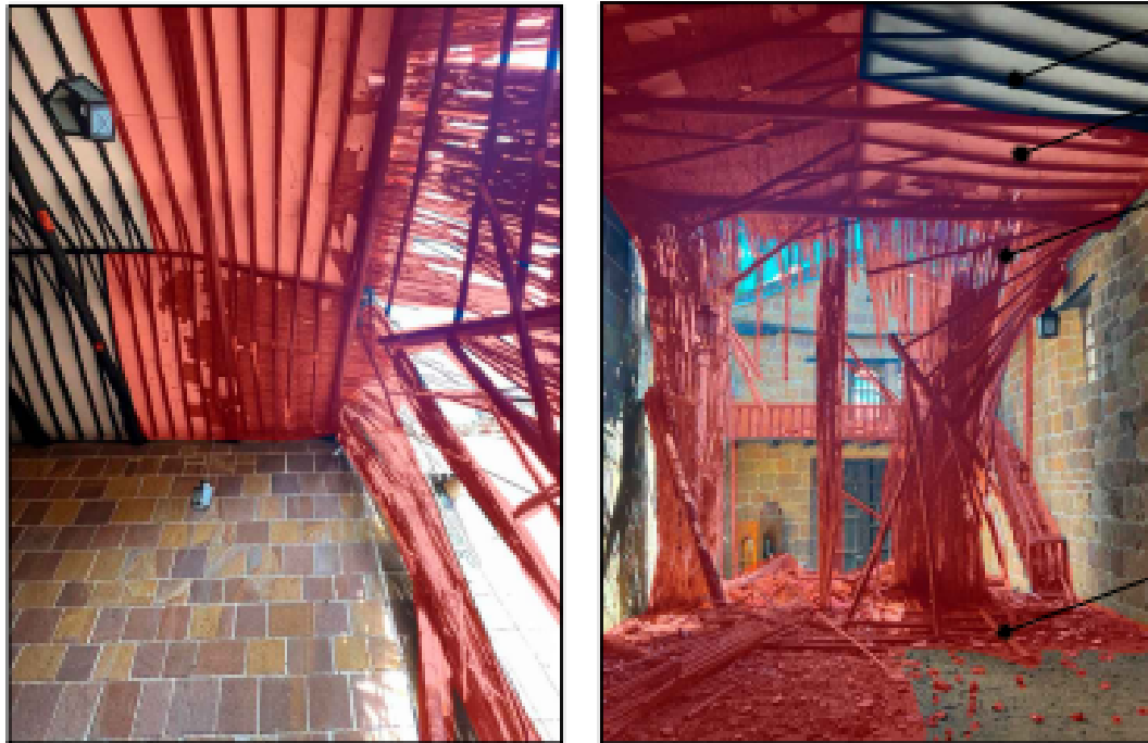
Desplome de cubierta
