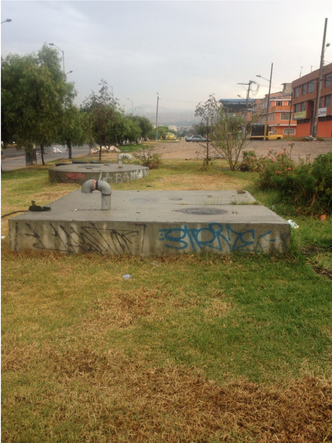
Ilustración 59. Cámara de acceso red de acueducto Línea Villavicencio 24"
