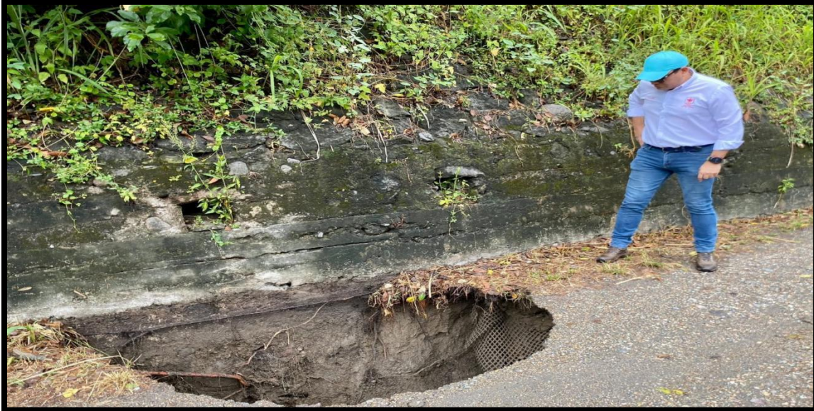
Imagen:4 Estado de un tramo de vía: Fuente: Alcaldía Municipal de Honda, Tolima
