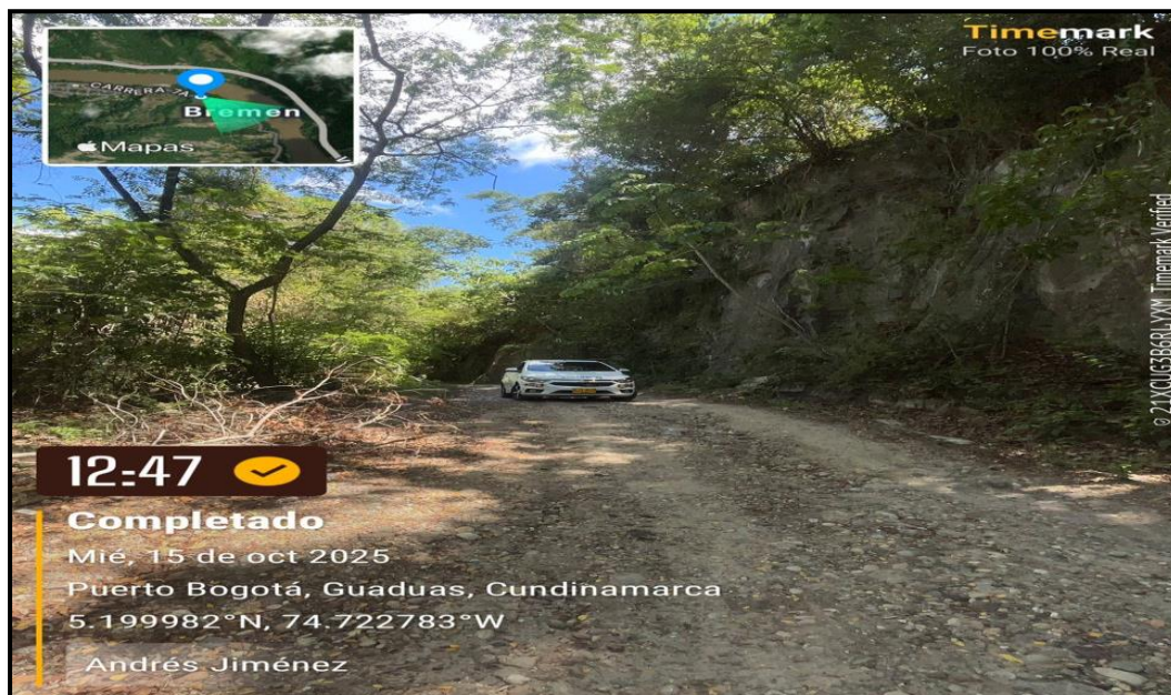
Figura 15 Falta de señalización horizontal.
