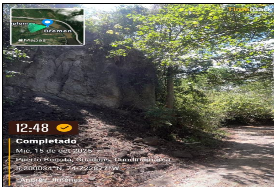
Figura 11 Talud cedido debido a erosión por agua lluvia Fuente: Registro fotográfico propio.
