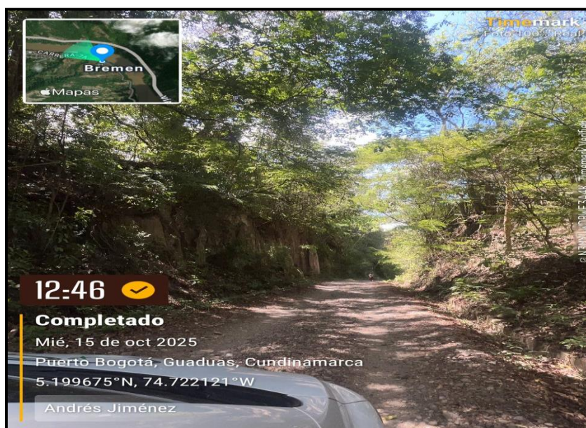
Figura 9 Estado deficiente del drenaje existente Fuente: Registro fotográfico propio.
