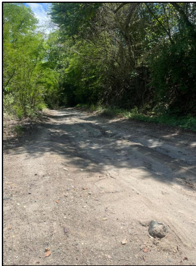
Figura 16 Condiciones actuales en las que se encuentra la vía
