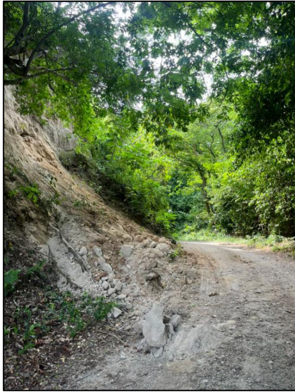
Figura 32 Zona del tramo a intervenir donde se presentan deslizamientos en los taludes.
