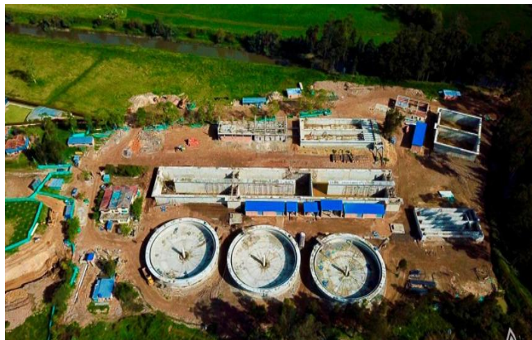
Ilustración 5 PTAR Chía 2 (El observador 2021)
