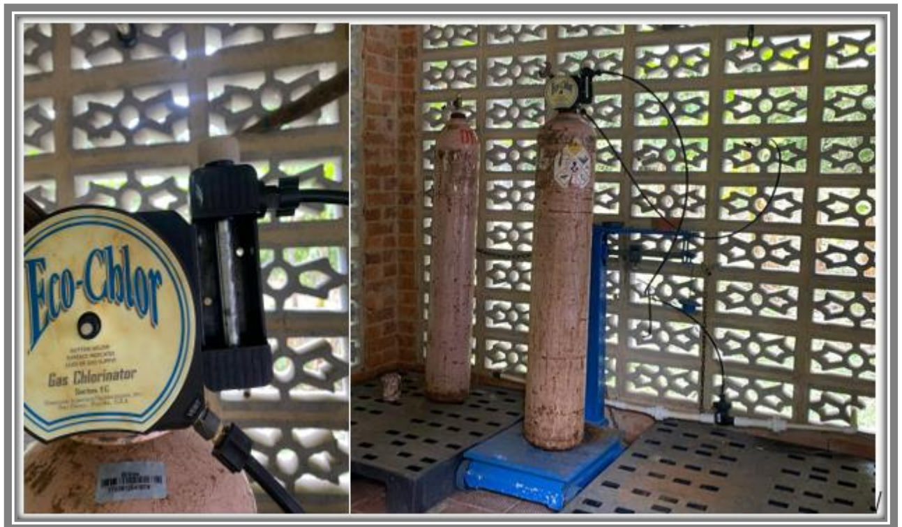
Ilustración 41 Clorador, bala de cloro e inyector.
