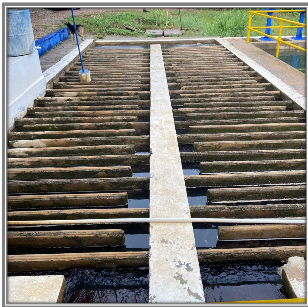
Ilustración 48 Cantidad de cámaras de floculación insuficientes.
