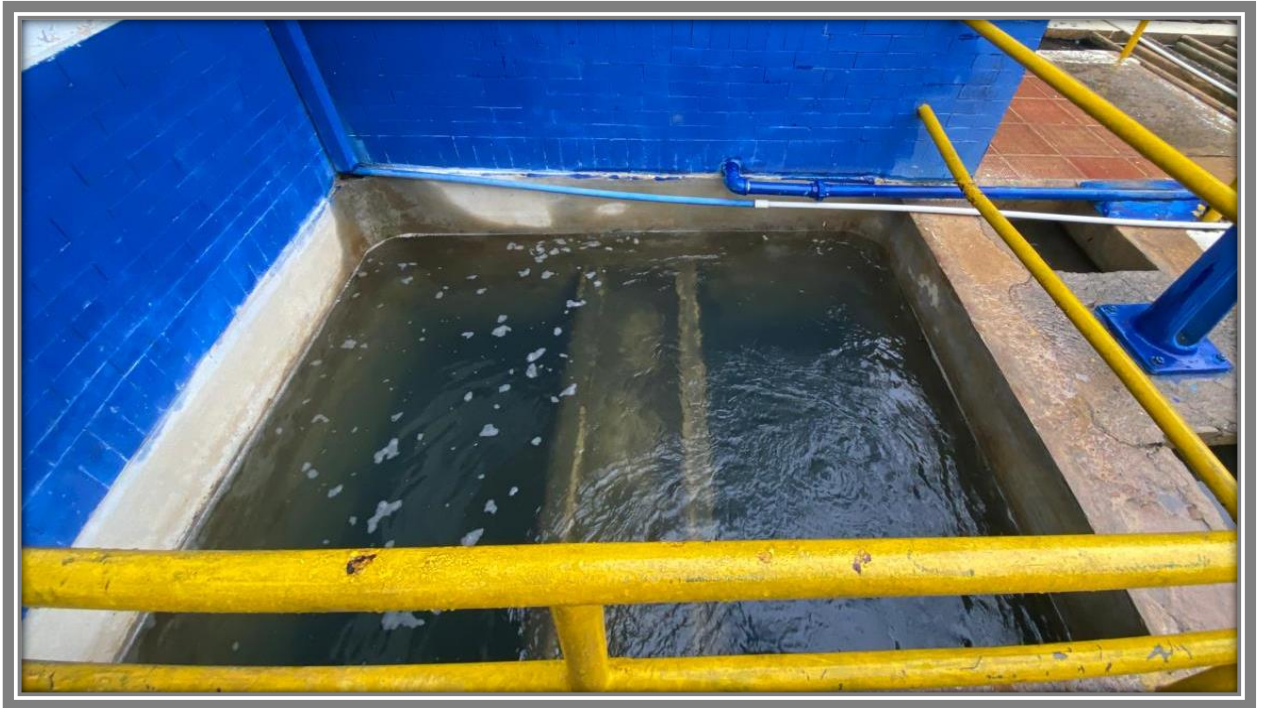
Ilustración 51 Unidades de filtros inadecuados.
