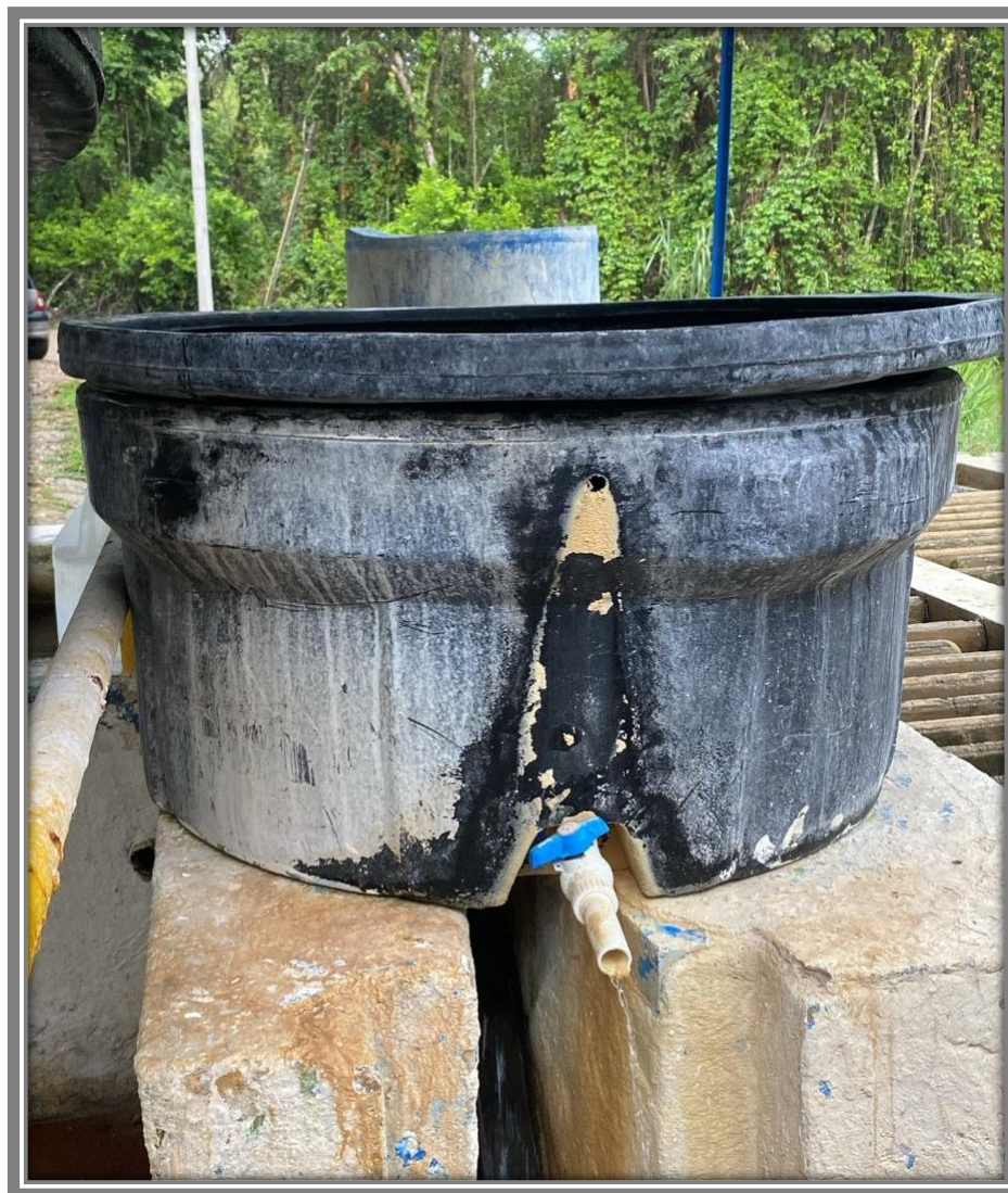
Ilustración 30 Tanque de 250L para suministro de sosa caustica
