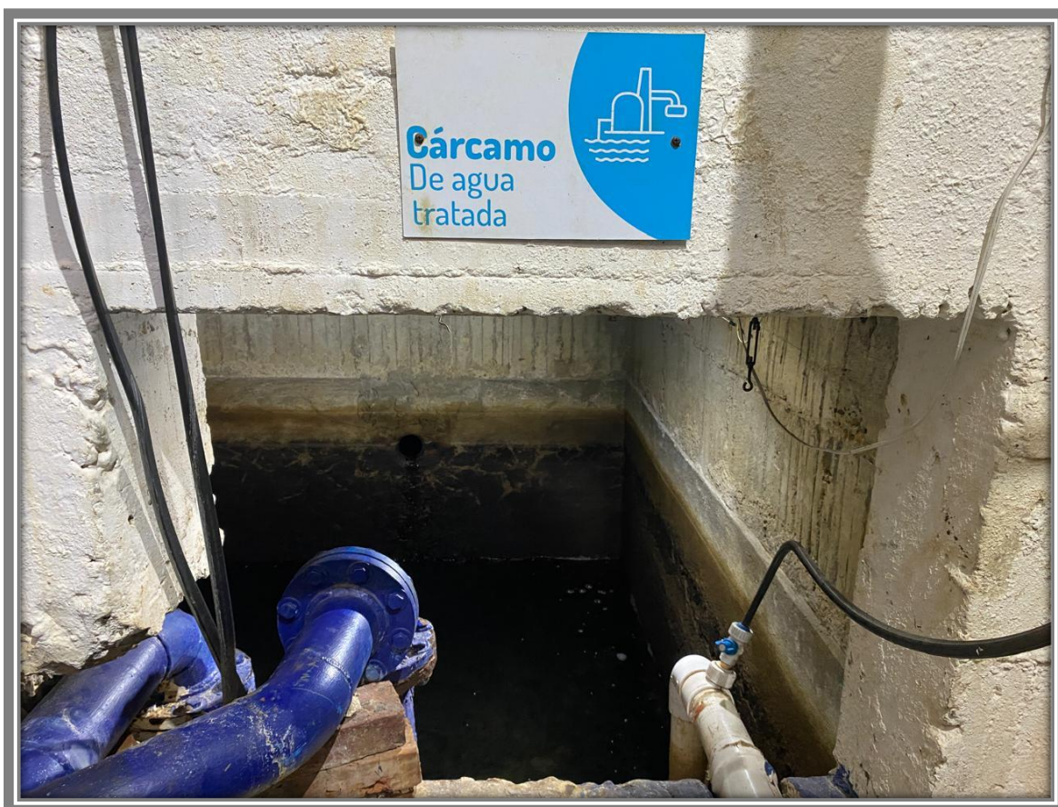
Ilustración 44 Cárcamo de agua tratada
