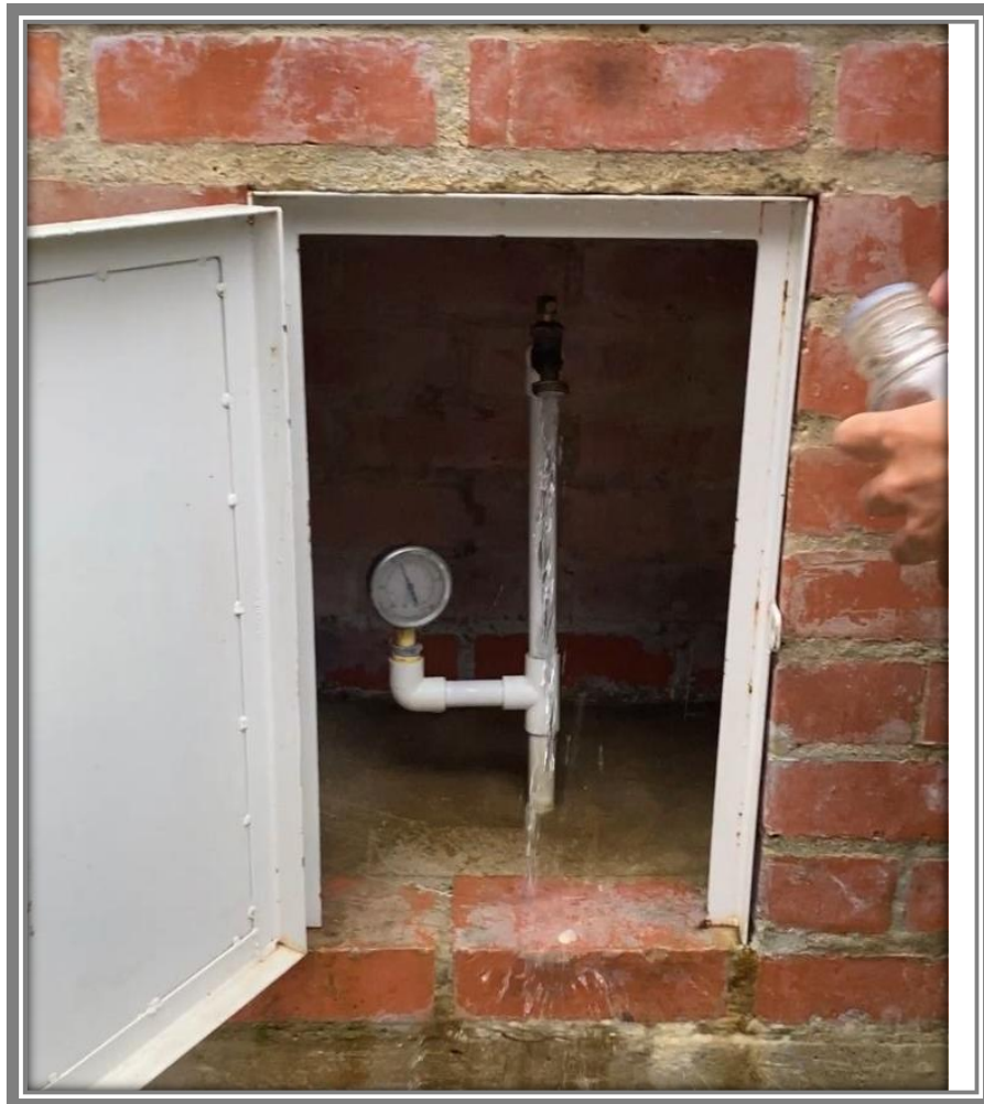
Ilustración 47 registro de salida de agua potable
