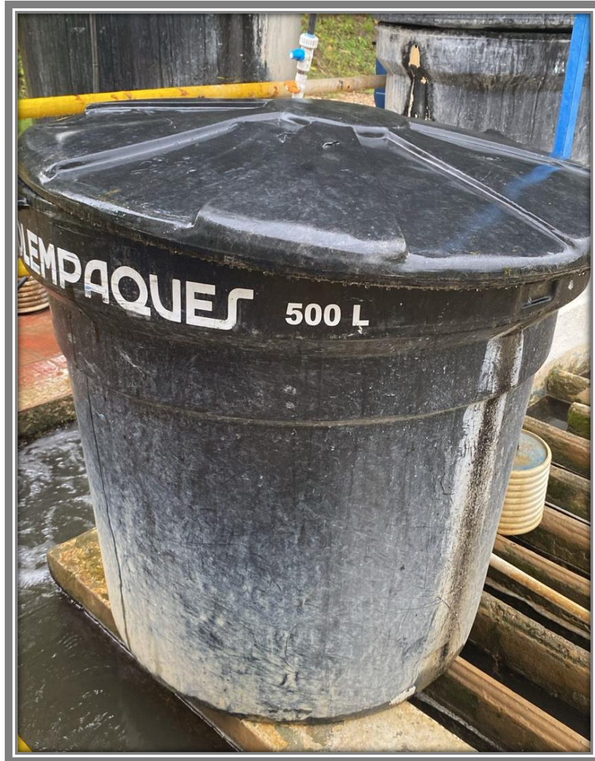
Ilustración 33 Tanque de 500L para disolver floculador granulado
