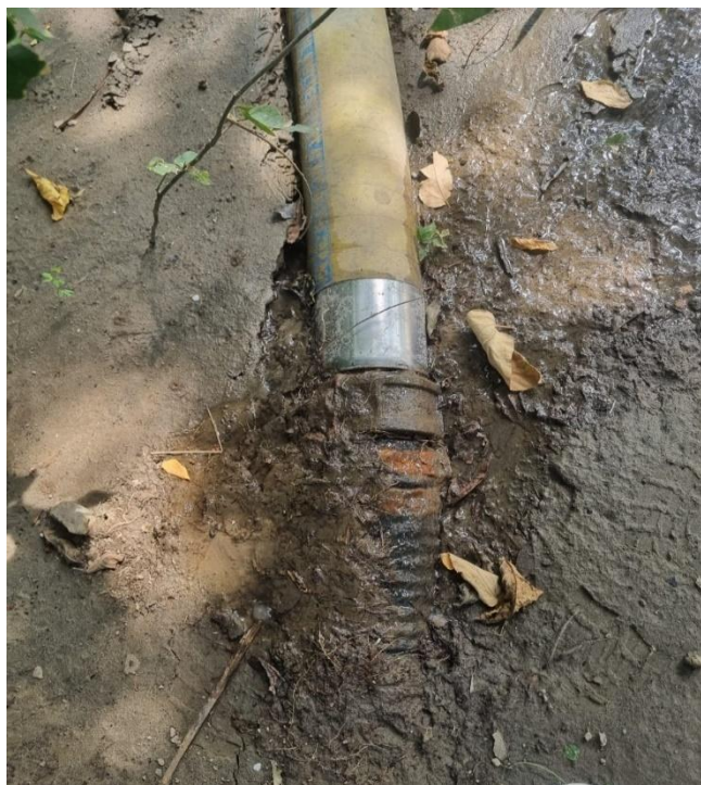
Figura 4. Fuga en la línea primera línea de aducción
