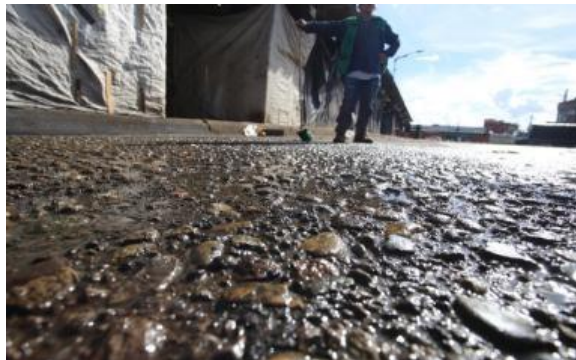
Figura 3. Losas de concreto afectadas por el ataque químico de la central de Corabastos.
