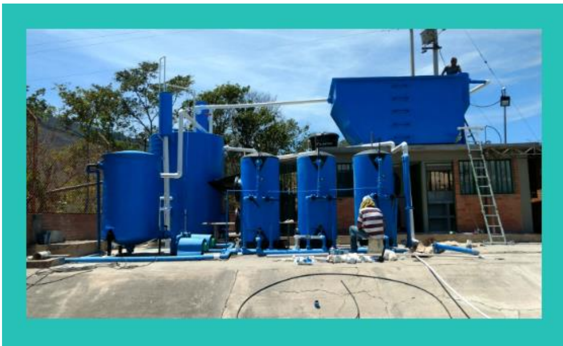
Figura 27. Plantas de tratamiento de agua potable en dos unidades (SERVIACUEDUCTO S.A.S , s. f)
