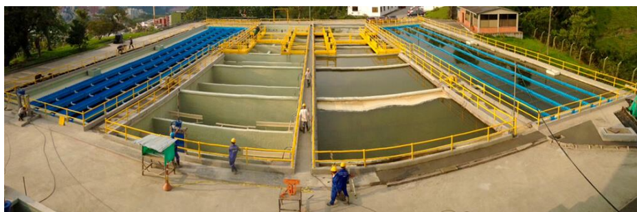
Figura 13. PTAP (Z.R. Ingeniería S.A., s. f)
