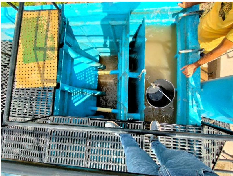
Figura 30. Limpieza módulo floculación Autoría propia
