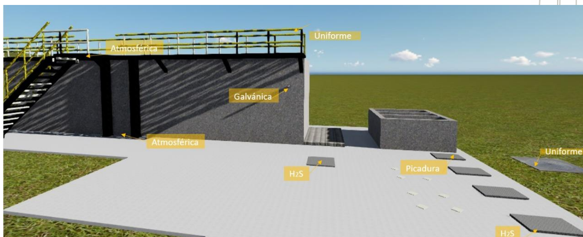
Figura 1. Tipos de corrosión encontrados según su ubicación.
