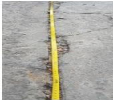
Figura 9. Deterioro sello de juntas.
