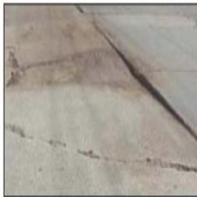
Figura 15. Falla por hundimiento y asentamiento.
