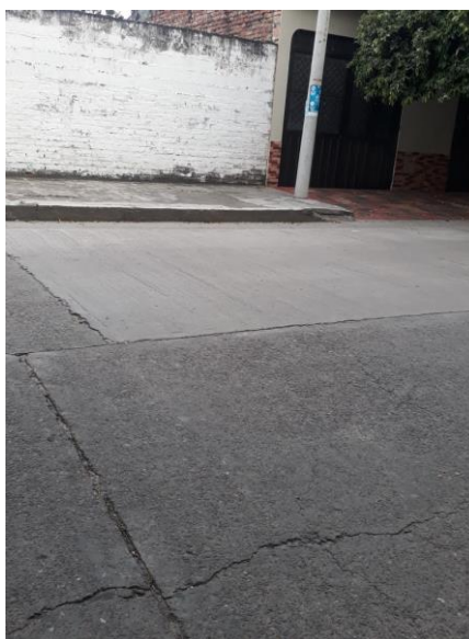
Figura 24. Falla grieta longitudinal y trasversal
