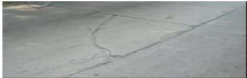
Figura 4. Falla grietas de esquina, Mancilla 2010.
