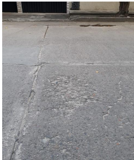
Figura 21. Falla perdida de agregados
