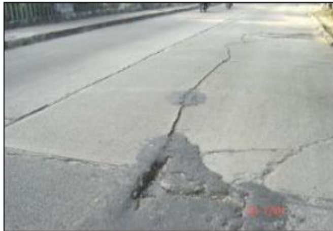
Figura 6. Fallas de grietas en bloque.
