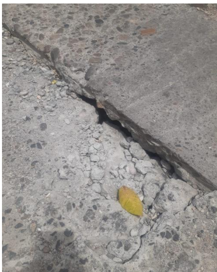
Figura 29. Falla por hundimiento
