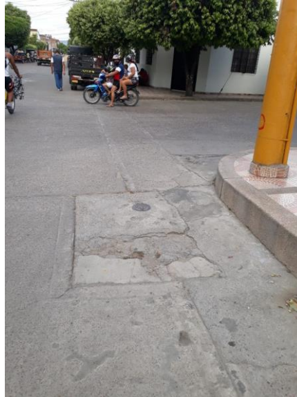
Figura 20. Falla de grieta en pozo y sumidero
