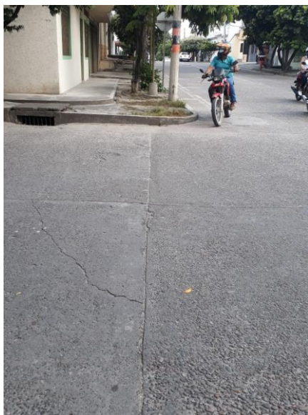
Figura 23. Falla grieta de esquina
