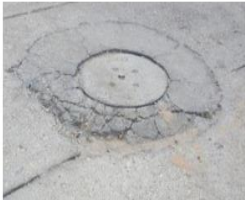
Figura 7. Daño por grieta en pozo o sumidero.
