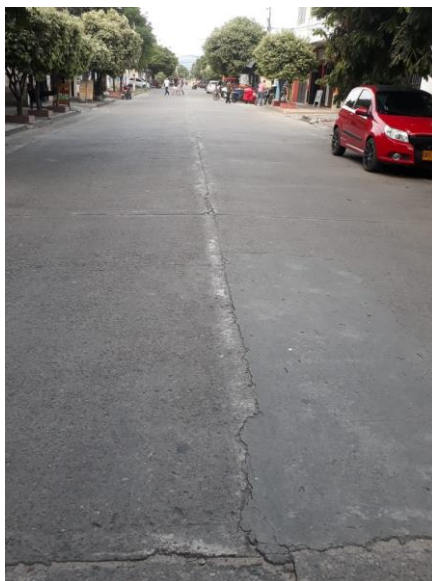
Figura 22. Falla deterioro de junta
