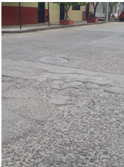
Figura 26. Falla por descascaramiento
