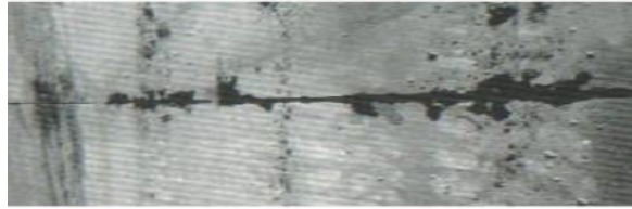
Figura 5. Falla por bombeo, Varela 2002.
