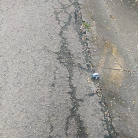
Grieta de borde
