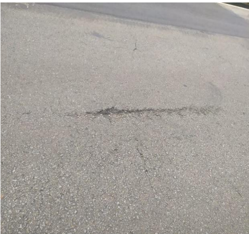
Grieta longitudinal y transversal
