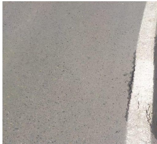
grieta al borde
