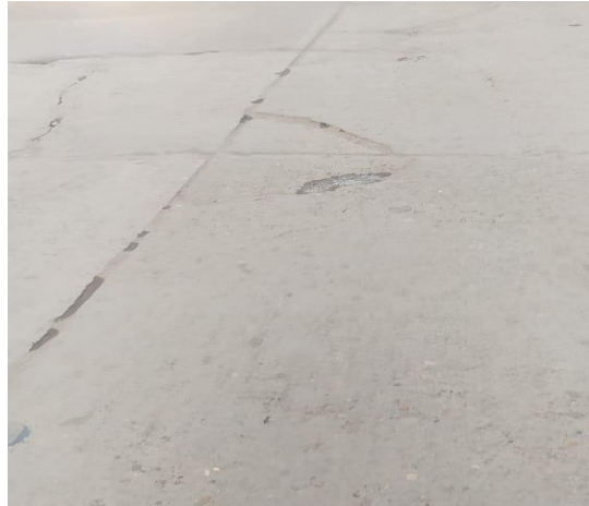
Grieta longitudinal y transversal
