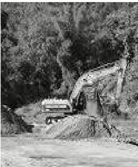
Explotacion indevida de materiales de construcción
