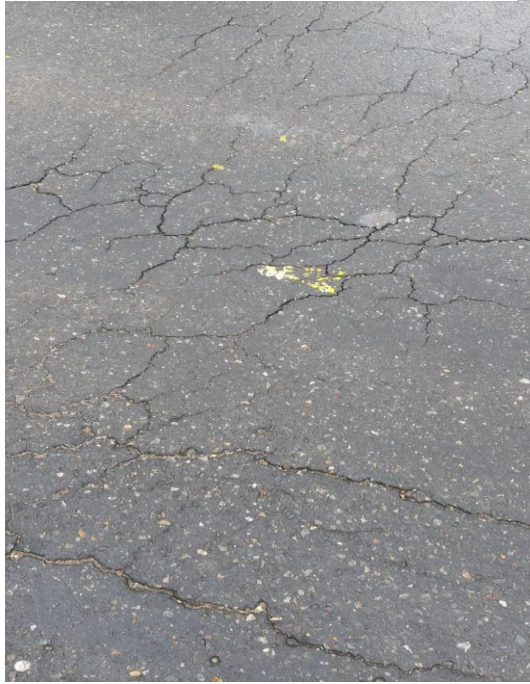
Piel de cocodrilo Carril B Tramo 9
