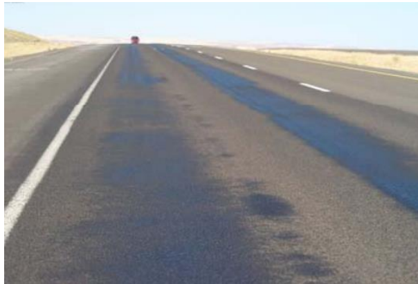
Imagen 6. Exudación de severidad media.
