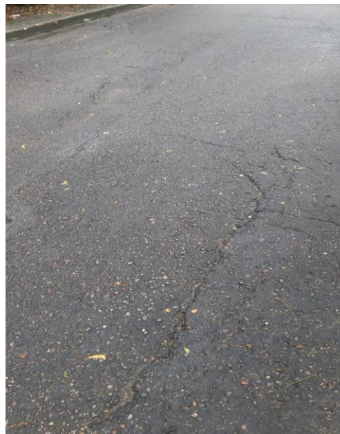
Grietas longitudinales Carril B Tramo 3
