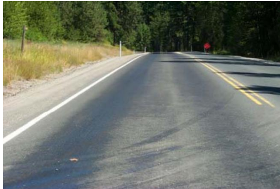
Imagen 5. Exudación de baja severidad.
