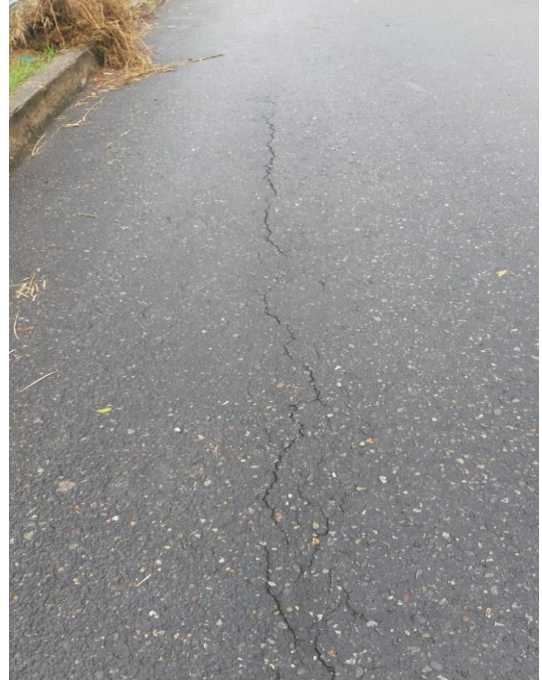
Grieta longitudinal Carril B Tramo 13
