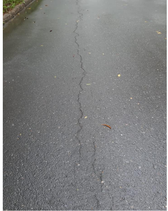
Grieta longitudinal Carril B Tramo 9
