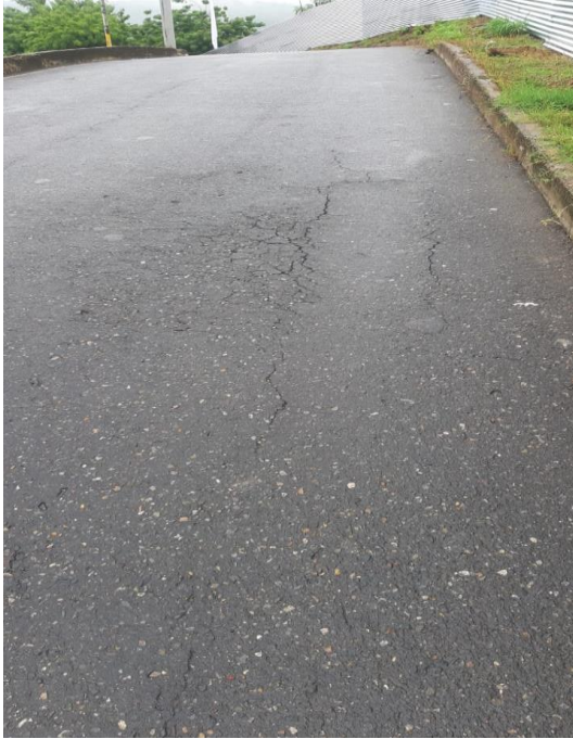
Piel de cocodrilo Carril B Tramo 13
