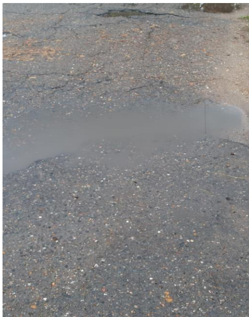
Depresión Carril B Tramo 3
