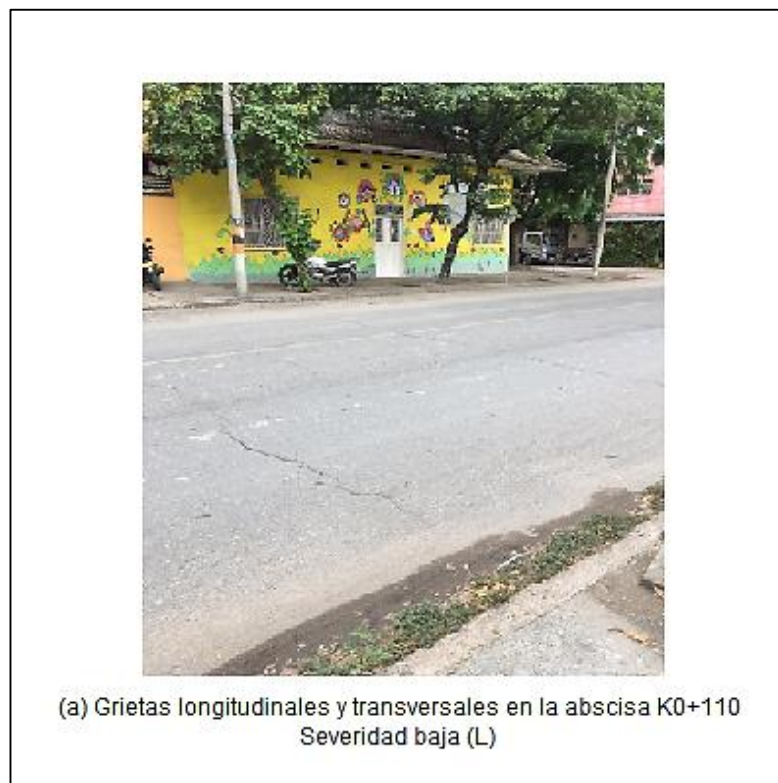
Ilustración 11. Grietas longitudinales y transversales en la vía (a).
