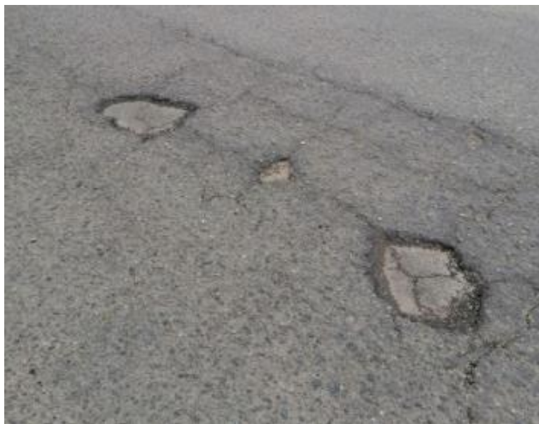
Figura 25. Huecos de mediana severidad.
