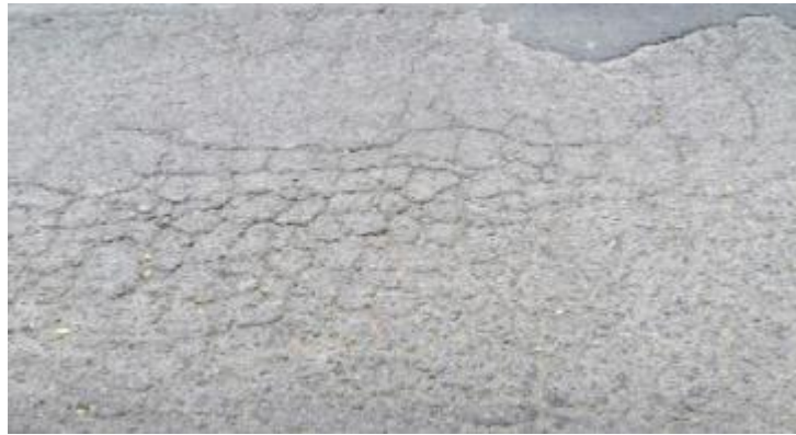
Figura 5. Piel de cocodrilo de media severidad.
