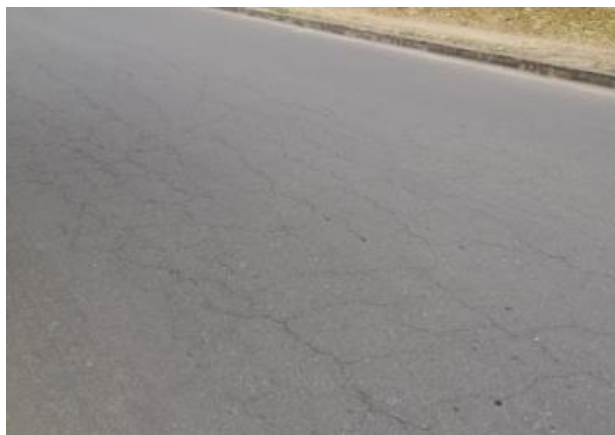
Figura 9. Fisuras en bloque.
