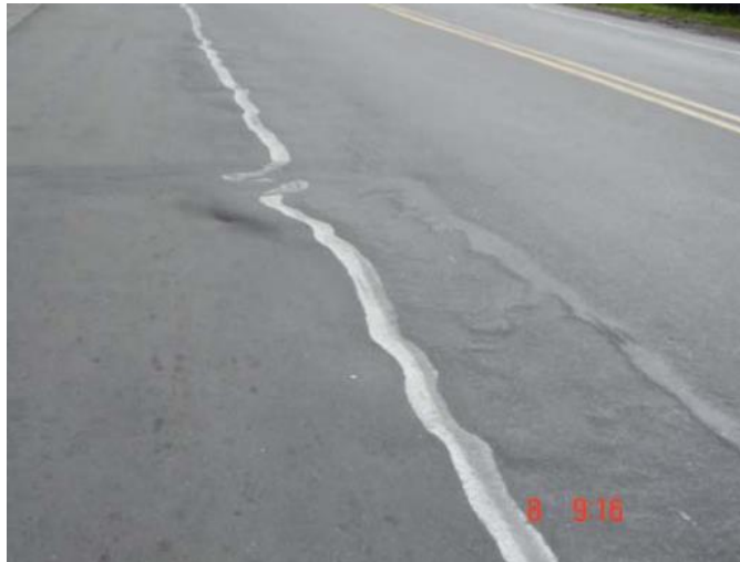
Figura 13. Corrugación u ondulaciones en una sección de vía.
