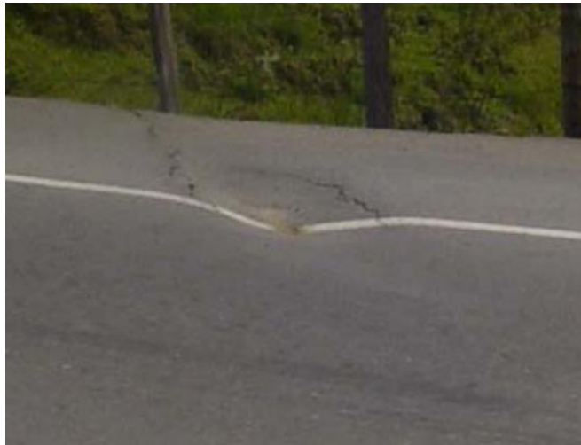
Figura 12. Hundimiento en una sección de vía.
