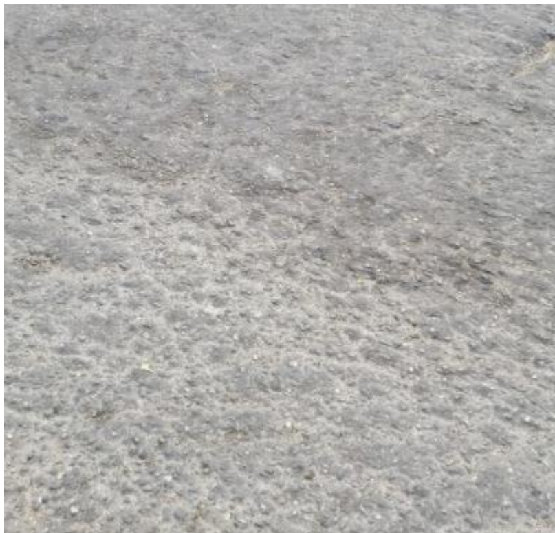
Figura 33. Pulimiento de agregados de alta severidad.
