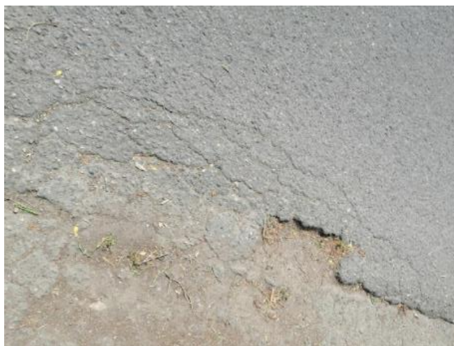
Figura 16. Fisura de borde de alta severidad.
