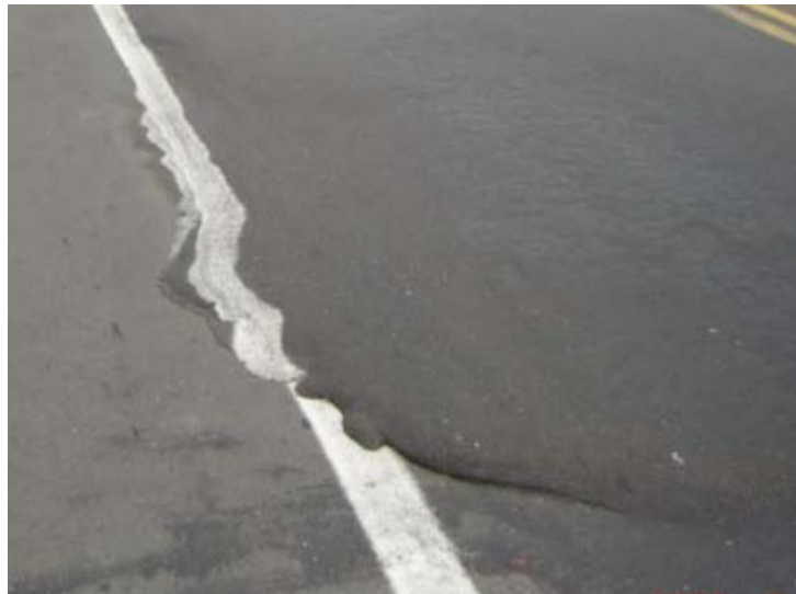
Figura 11. Abultamiento de una sección de vía.
