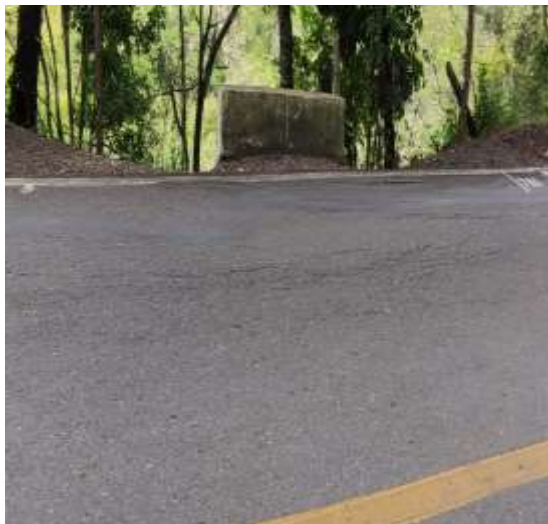
Ilustración 18 agrietamiento en bloque
