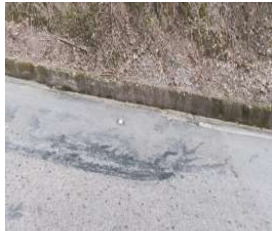
Ilustración 15 grieta de borde
